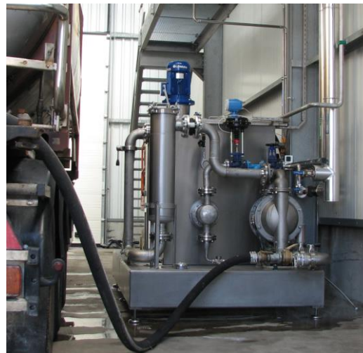
Bomba de retorno e filtro
