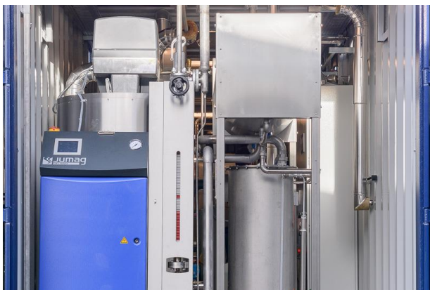
Gerador de vapor
