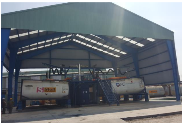
Depósito de tanques Ho Chi Minh
