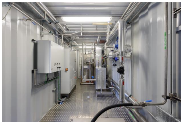
Contêiner com equipamentos de Limpeza
