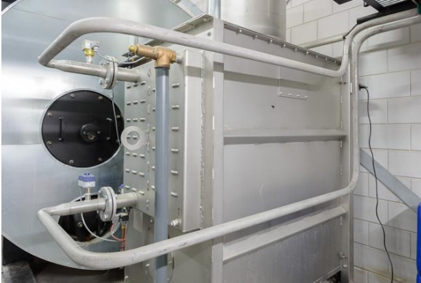
Recuperação de energia de fumos da caldeira a vapor
